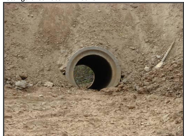
Foto 23.4. Galerias de drenagem. Fonte: CEMAFAUNA.
